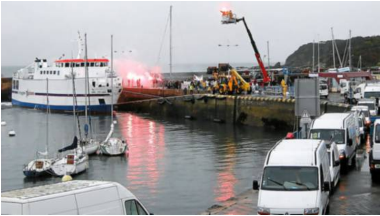
Camions, pelleteuses, camionnettes et engins de chantier étaient en position dès 8 h 30, sur le môle central.
